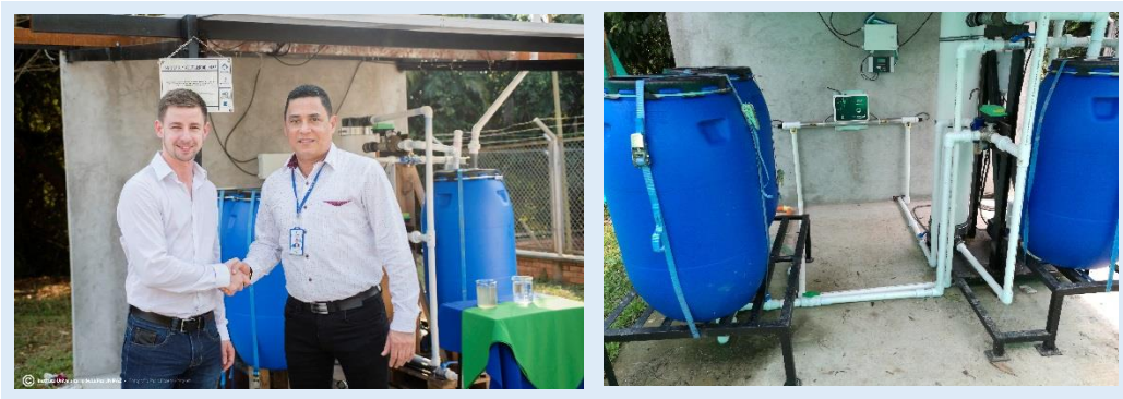
Figura 13. Planta de potabilización de aguas
