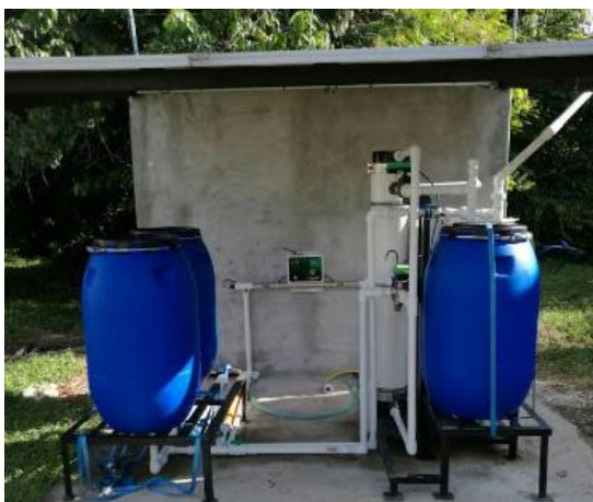
Figura 2. Módulo de potabilización, CISL, UNIPAZ.
