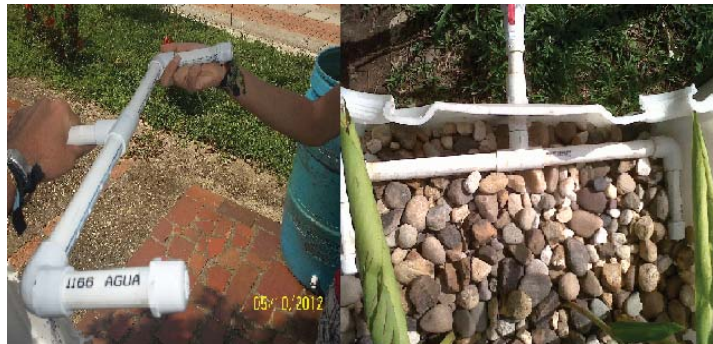
Figura 1. Flautas dispersoras en el modelo 1 para descarga del agua residual en el piloto humedales artificiales. Fuente: Quintero y García, 2012.
